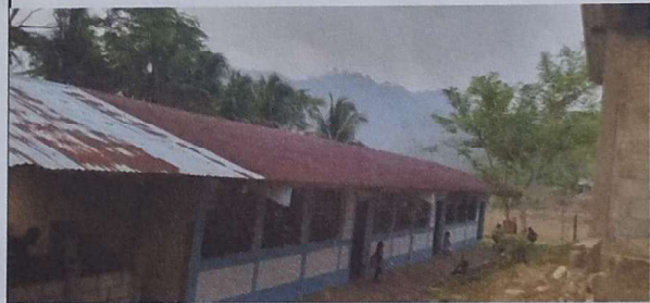
Foto 4: Se observa el deterioro de las laminas del modulo 2.
